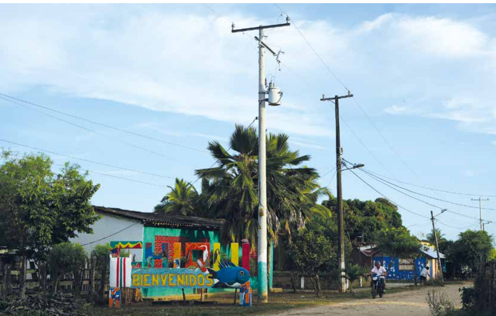
Transformador eléctrico instalado en Chiquí para el suministro continuo de agua.
